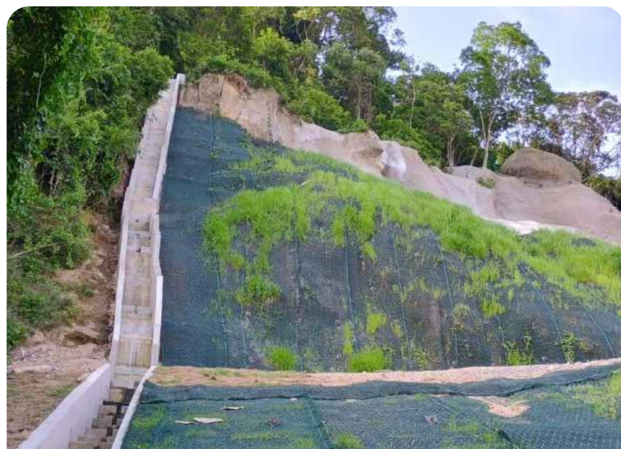
ILHÉU ALTO GANHA MAIS SEGURANÇA APÓS OBRAS DE DRENAGEM E DE ESTABILIZAÇÃO
